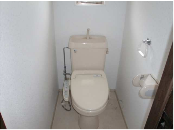
トイレ 温水洗浄便座
